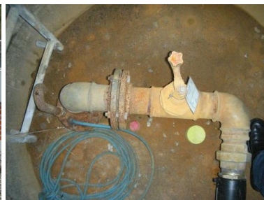
Tørbrønd B1 Tegn på utæthed
