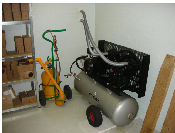
Kompressor med luftindtag fra vandværk
