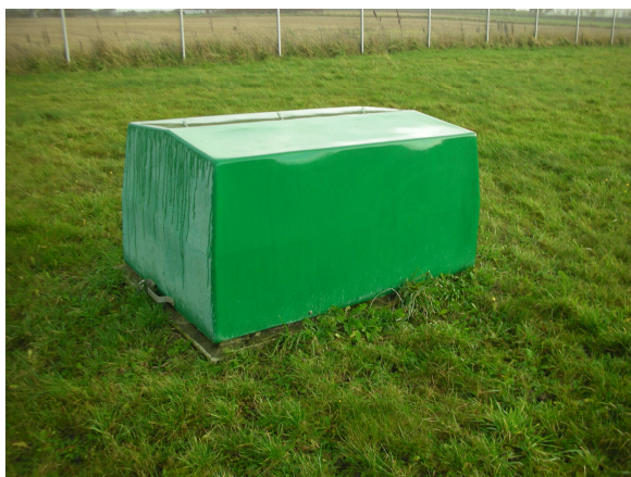
Terrænstation. Bedre med fliser omkring
