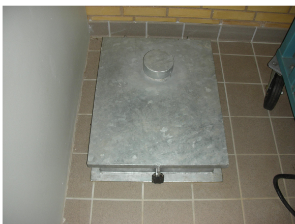
Nedgang til rentvandstank
