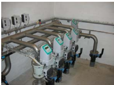
4 udgange med elektronisk måler samt rå- vandsmåler bagerst.
